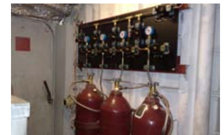
Рис. 5. Гелиевые баллоны и распределительный щит гелия Figure 5 Helium Cylinders and Helium Feeder Switchboard
